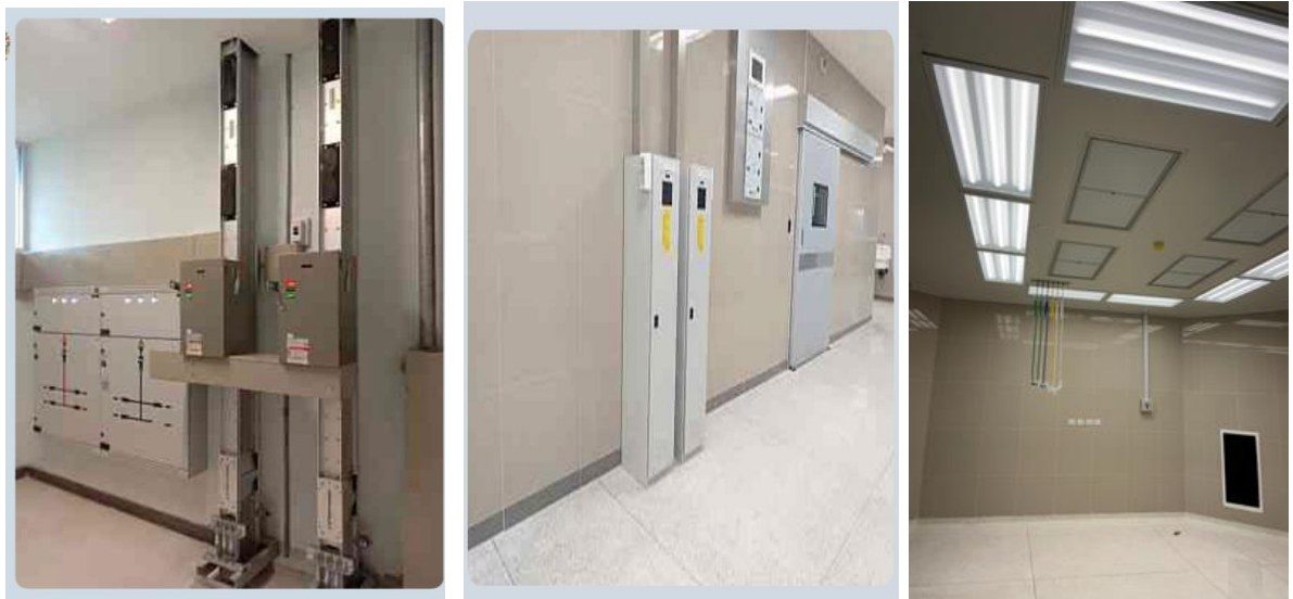
รูปที่ ๖ แสดงการติดตั้ง BUS DUCT และภาพขาวเป็นชุดควบคุมระบบไฟฟ้าสำหรับห้องผ่าตัดและ ICU ประกอบด้วย ห้องผ่าตัด และหอผู้ป่วยหนักที่มีระบบไฟฟ้าแบบ IT ตามมาตรฐาน
