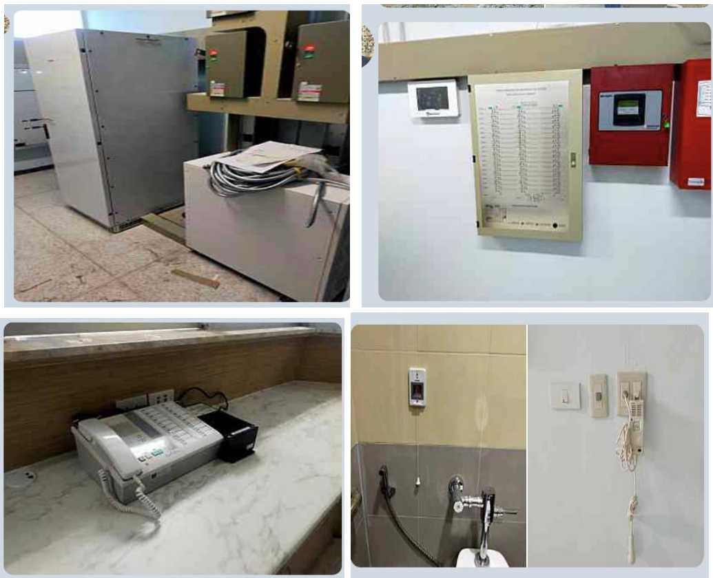
รูปที่ ๗ ชุดควบคุมระบบไฟฟ้าสื่อสาร ไฟโถและ nurse call
