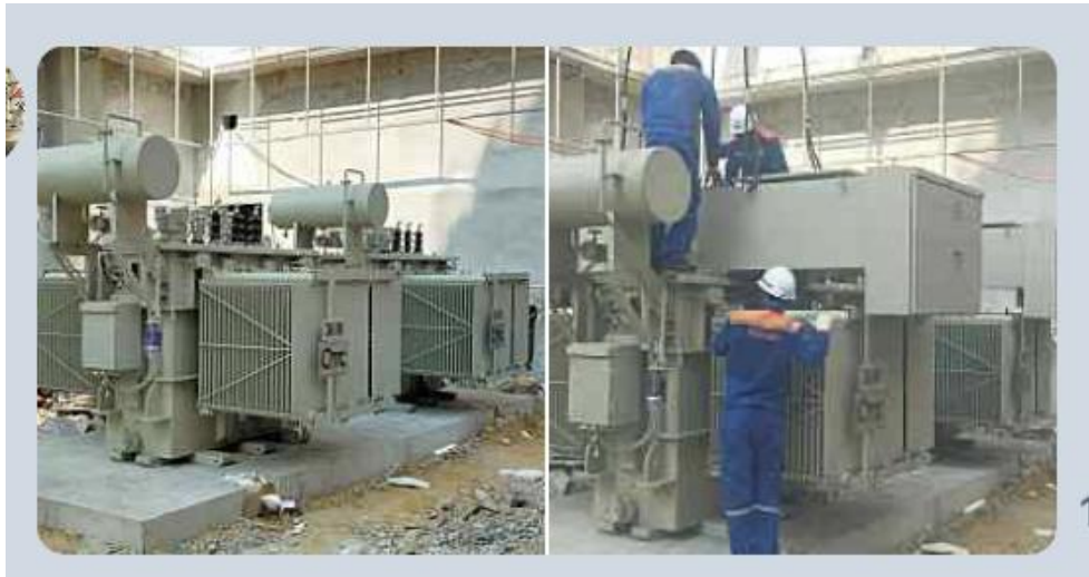
รูปที่ ๘ ติดตั้งหม้อแปลงไฟฟ้าขนาด ๓๖๐๐ kva
