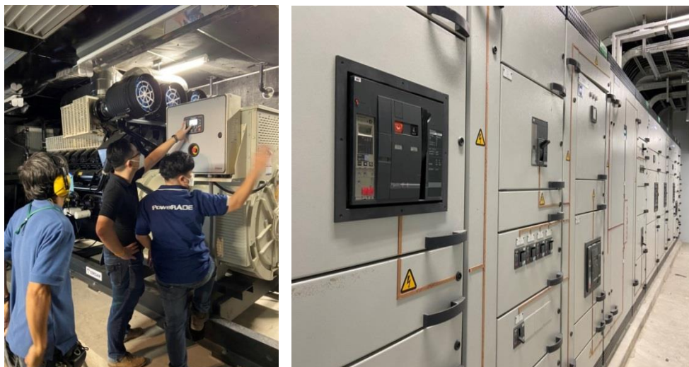
รูปที่ ๙ ติดตั้งเครื่องกำเนิดไฟฟ้าขนาด ๑๘๐๐ kva และ ตู้ควบคุมไฟฟ้าหลักของอาคาร
